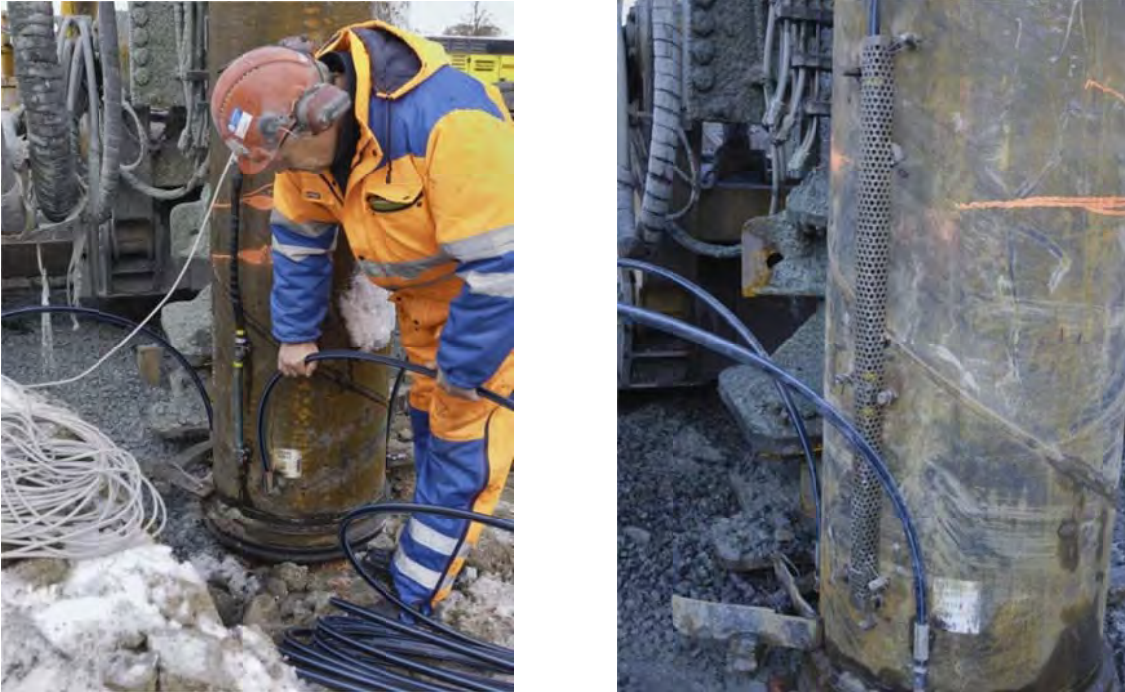
Figur 8: Totaltrykceller montert på spuntrør. Rør for injeksjon mellom rør og berg er påmontert. Til høyre modifisert montering med beskyttelse.
