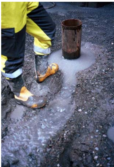
Figur 2-22 Innlekkasje av vann langs foringsrør til stålkjernerpel (Bilde: Jernbaneverket, Dobbeltspor Sandvika-Asker).
